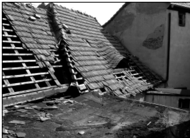
Spadające dachówki mogą być przyczyną nieszczęścia
